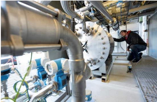
Marc-Simon Löffler, Leiter des Fachgebiets Regenerative Energieträger und Verfahren am ZSW, vor einem Elektrolyseblock.
